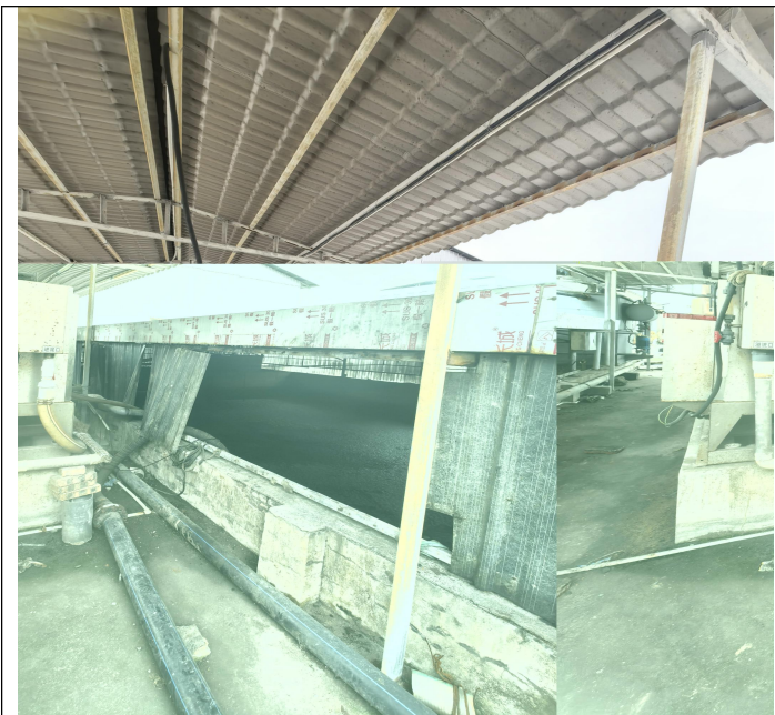
厂内废水预处理设施
